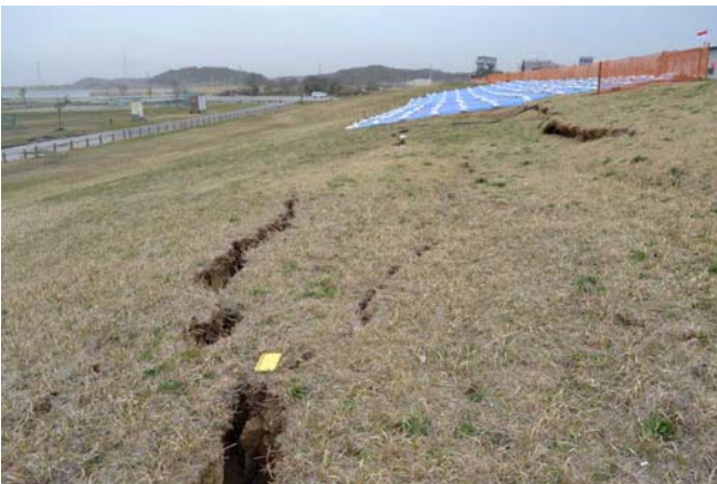
9 佐原利根川堤防(右岸)に発生した亀裂とその復旧
