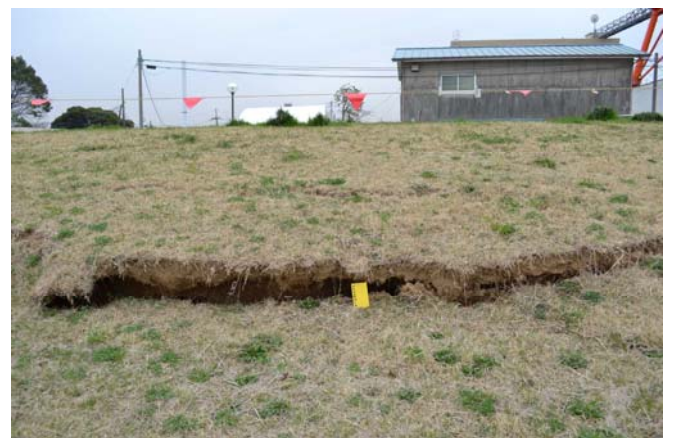
10 佐原利根川堤防(右岸)に発生した亀裂
