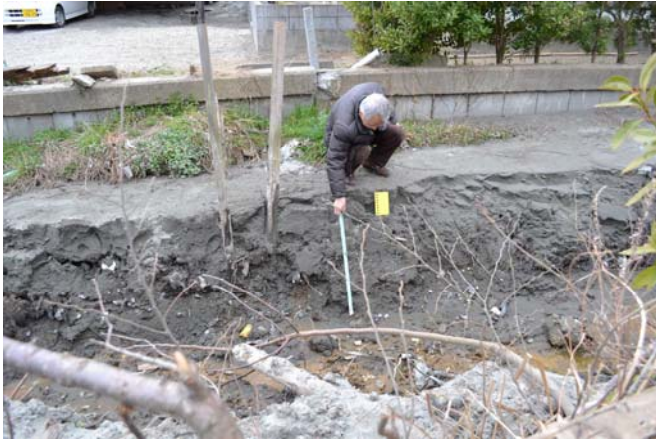
5 佐原下川岸の十間川で発生した噴砂の河床堆積 液状化により河床から大量の土砂が噴出し堆積した。
