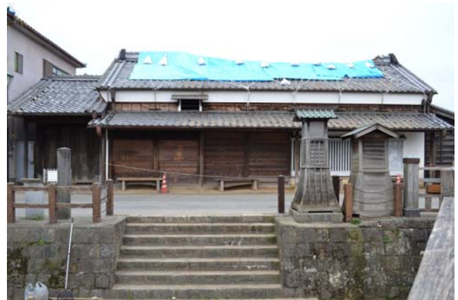
2 伊能忠敬旧宅屋根瓦の被害 2011.4.3
