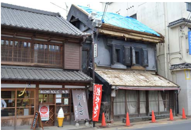
1 千葉県文化財指定「正文堂」屋根瓦の被害
